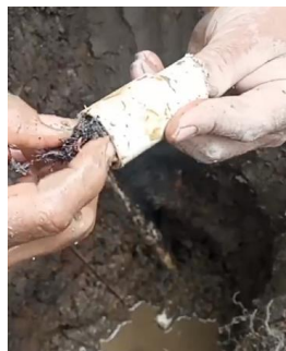
Imagen del taponamiento en la salida tanque Peña Negra – Ramal San Antonio Bajo
