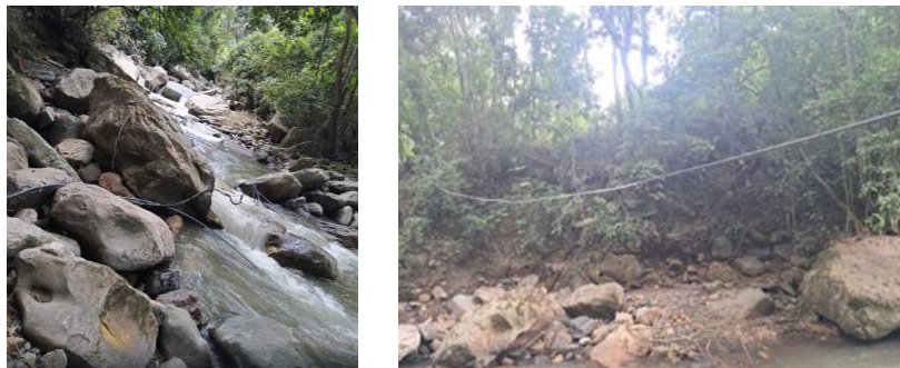
Imagen de la reparación del ramal sobre el río Bahamón sector la Hamaca
